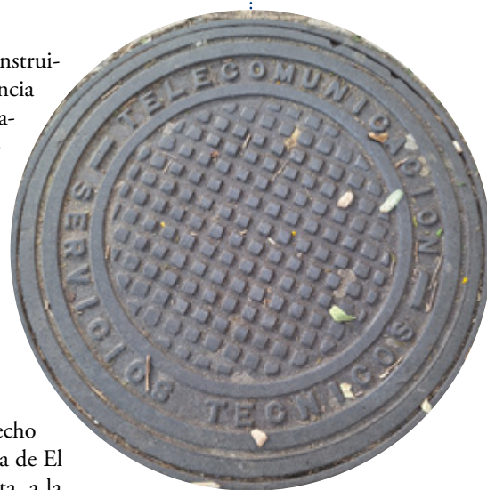
Tapa de canalización de Telecomunicación
